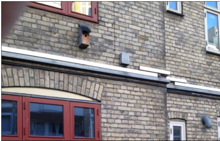
Coax-kablerne og andre, gamle kabler ligger i de hvide og grå plastikkasser på bagvæggen af vores huse
