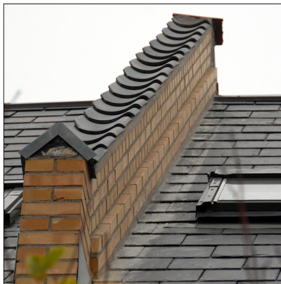
En reparation som ikke helt følger håndbogens anvisninger
