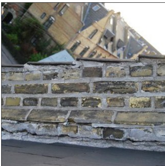
Brandkam der trænger til reparation
